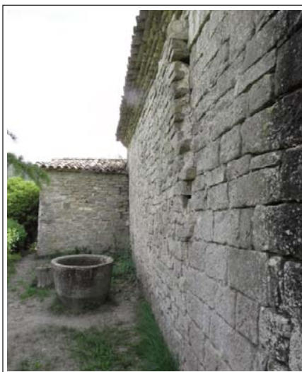
SANT PERE DE VALLHONESTA. Façana de tramuntana amb el mur del segle XII desplomat
