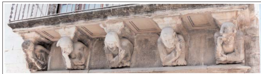
CERVERA. EDIFICI DE LA PAERIA. Detall de les mènsules d'un dels balcons.
