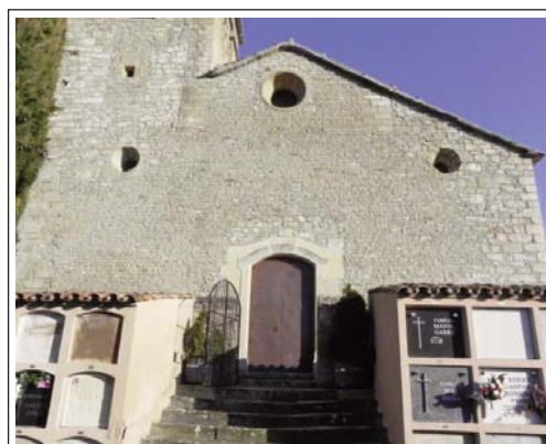
SANT ANDREU DE CASTELLCIR. Façana de ponent, fotografiada des del cementiri. La façana, sense el revestiment que la protegia, ens marca les vicissituds passades al llarg del temps.
